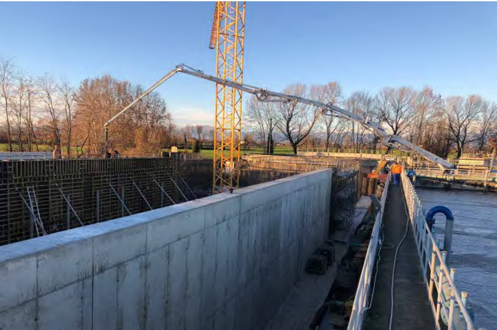
Cologno al Serio (BG) UNIACQUE S.p.A. Adeguamento impianto di depurazione con nuove vasche di trattamento biologico
