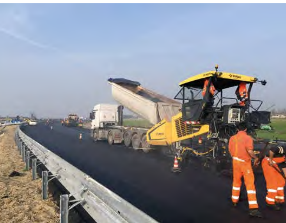
Fondazioni stradali e pavimentazioni in conglomerato bituminoso Lotto OG-OH - Romano di Lombardia (BG)
