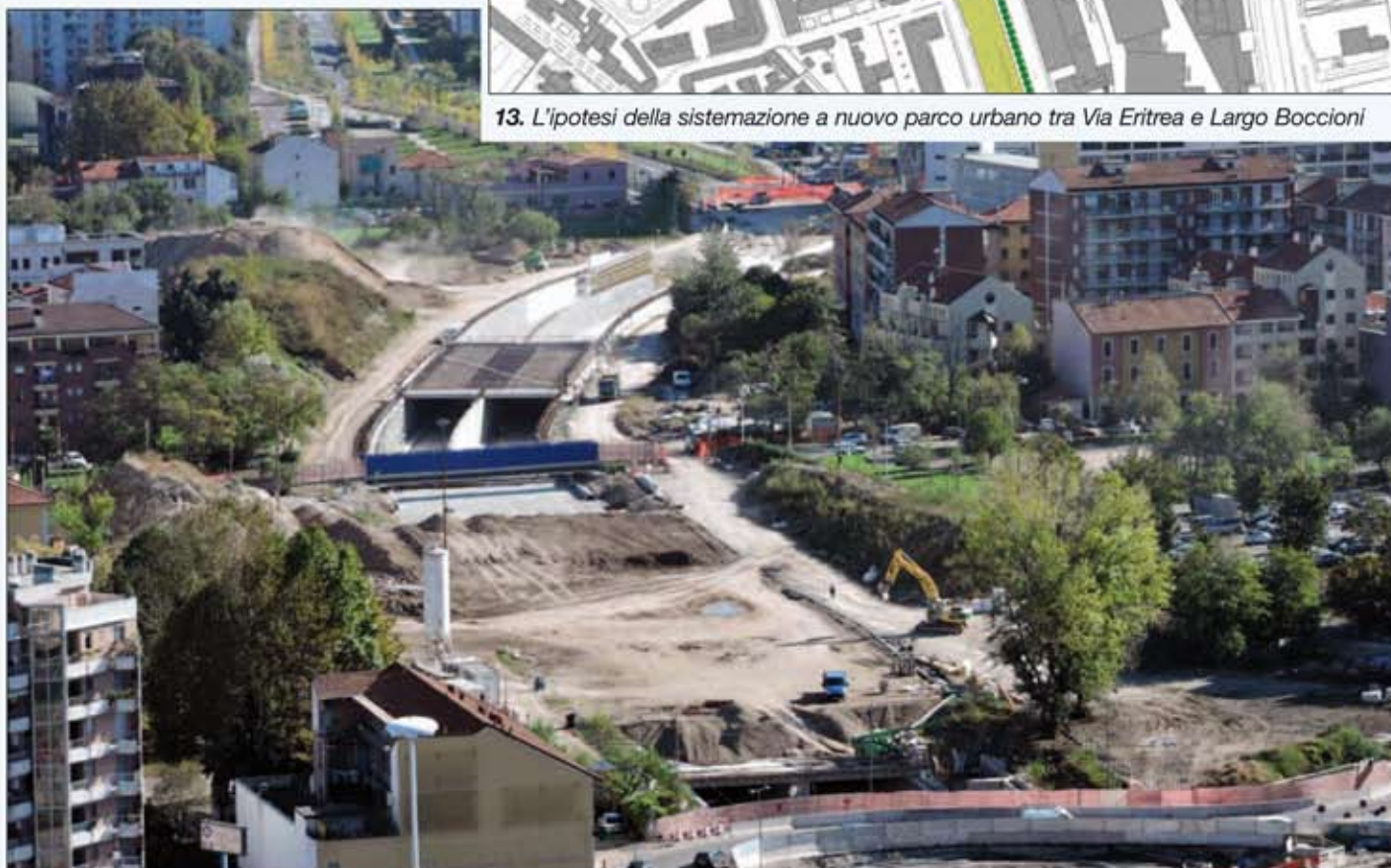
14. Una panoramica del cantiere dell'asse stradale che collegherà Via Eritrea con il sito Expo 2015
