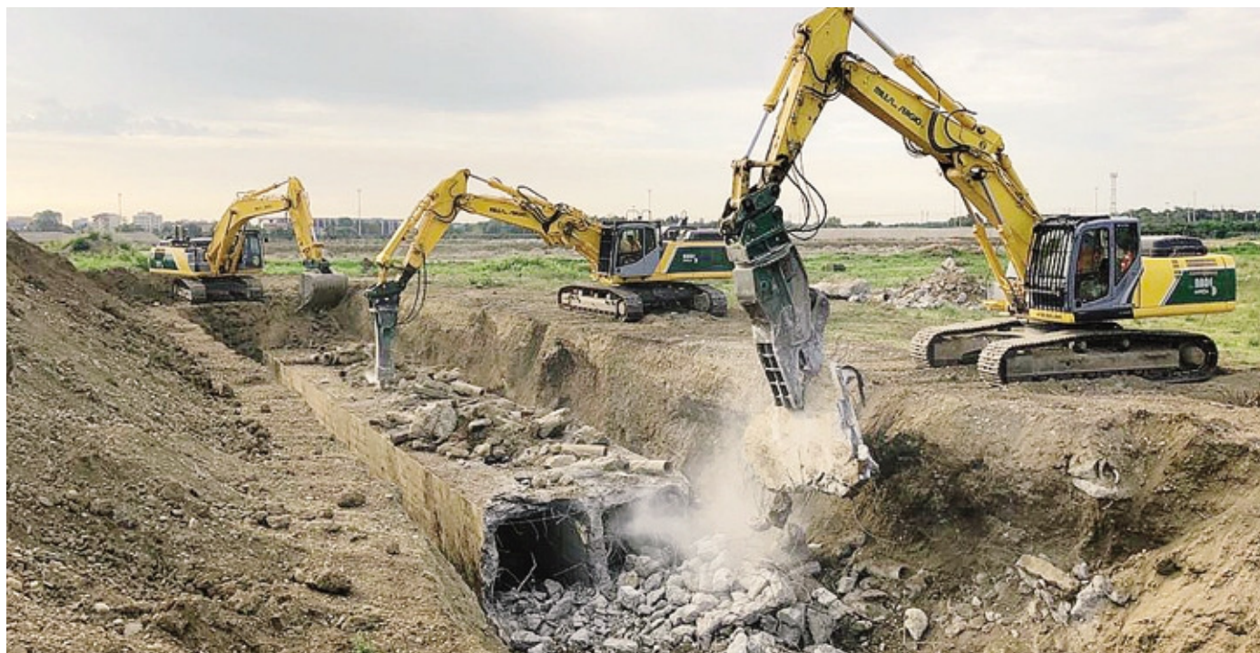
La Milesi si è occupata di tutte le opere di demolizione delle strutture preesistenti nell'area dove sorgerà il mega centro Westfield a Segrate
